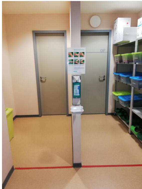
Abb. 3) Personalschleuse in einem ambulanten OP © A.-S. Schinzel
